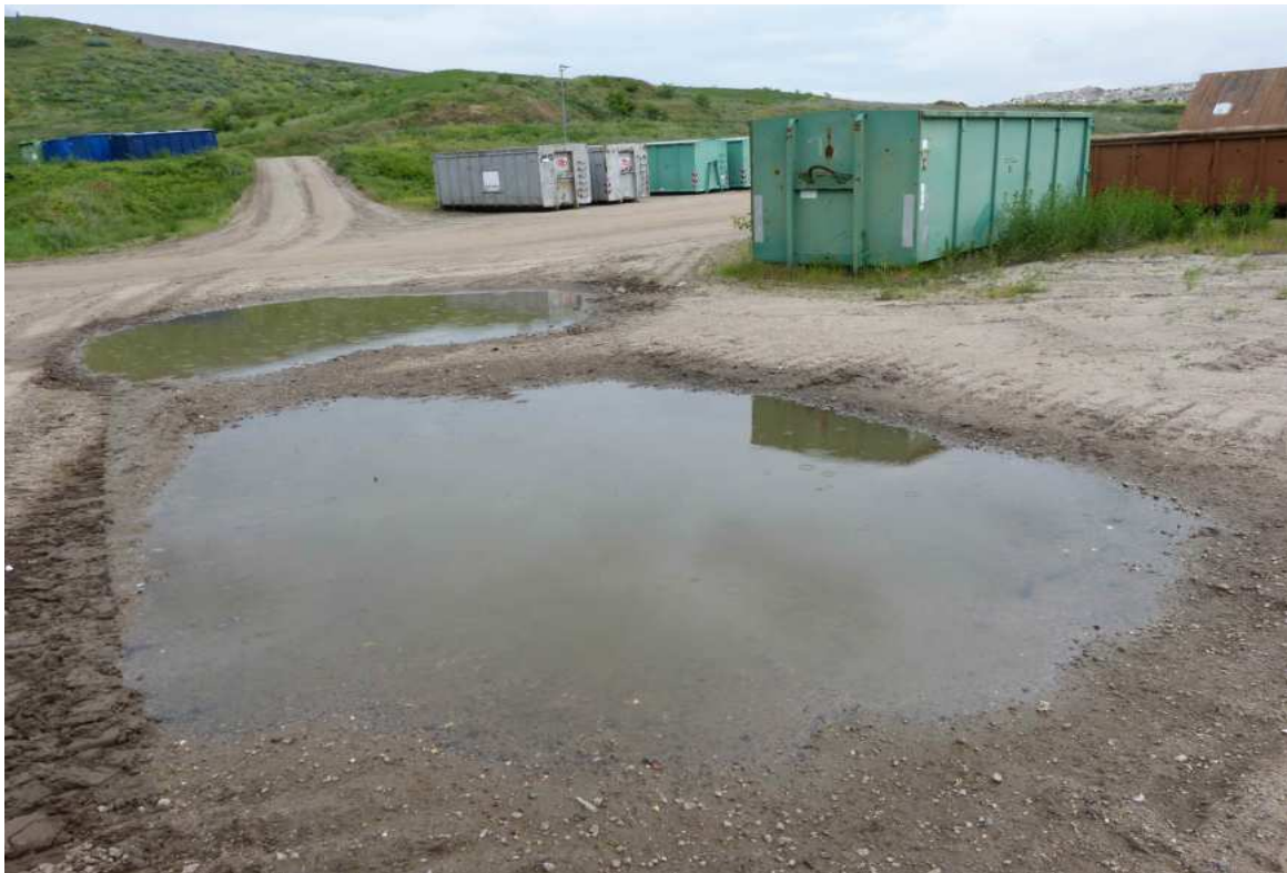
zwei große Wasserflächen in der Fahrspur, 15.5.24
